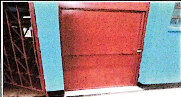
Foto 2: Sustrucción de puerta
